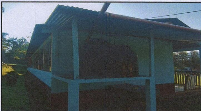
Foto1: Canales y bajada de agua Pluvial
